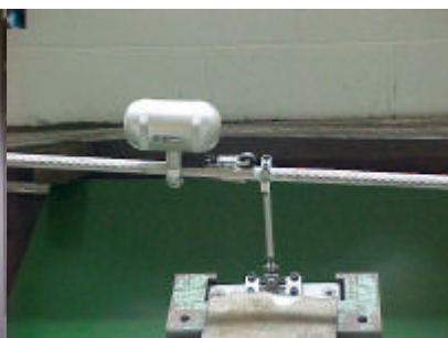
Fig.8 vibrôgrafo pavica instalado
