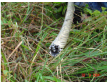
Fig.2 cabo condutor rompido ao solo
